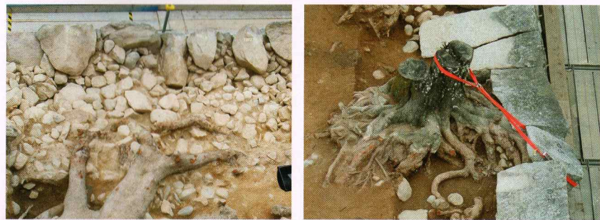
石垣を押し出す樹木の根 (左:1面石垣裏、右:10面石垣裏) 1面石垣裏と10面石垣裏では、樹木の根が石垣石材を直接圧迫している。
