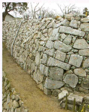
1・2面石垣のはらみ
