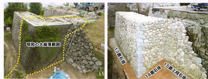
13～15面石垣で生じた大規模崩落 黄色破線内が大規模崩落の範囲。 修理後の13～15面石垣 本来の平面形状に復旧。
